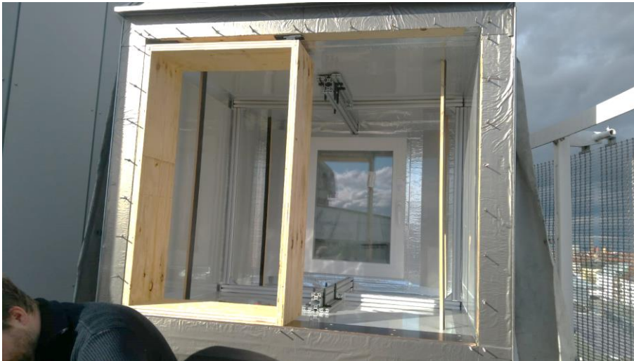
Abbildung 3: Vorbereitungen für die Montage der Fassadentestelemente. Hier zu sehen ist ein leerer Rahmen, der mit Flexkeilen oben eingespreizt wurde.
