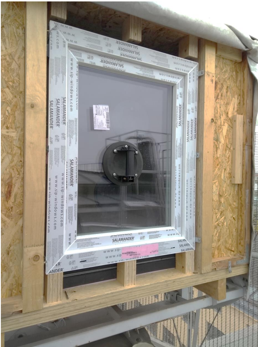
Abbildung 1: Einbau eines Fensters mithilfe der Flexkeile. Die Verglasung liegt in einer Ebene mit den innenseitig montierten hochdämmenden Vacuumisulationspaneelen (hier nicht sichtbar).
